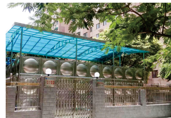
汉阳赛博园二次供水设施
